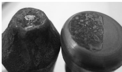
Рис. 9. Изношенный дугогасительный контакт после 100 операций – 100 В (слева) и дугогасительный контакт после 160 операций – 20 В
